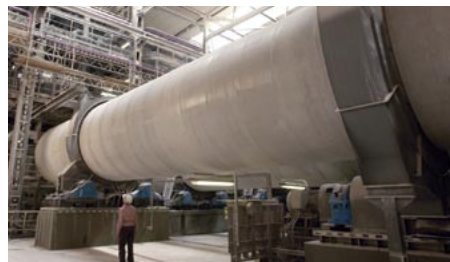
In 30 Meter langen Drehrohröfen wird Rohbicarbonat mit 200°C heißem Dampf thermisch in Soda umgewandelt.
